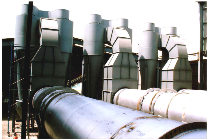
Instalación de ciclones en proceso industrial.
