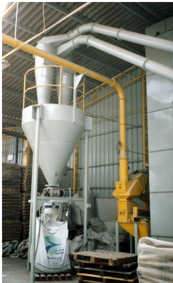
Transporte neumático a equipo de ensacado
